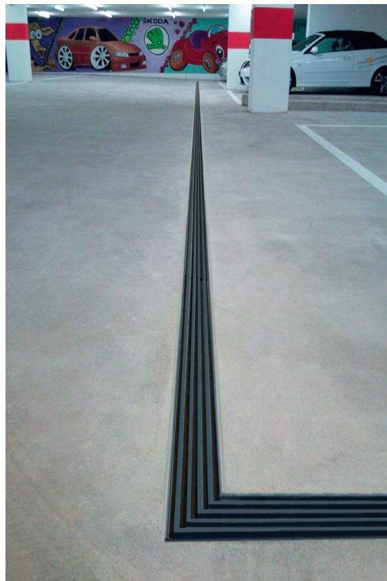
AquaStop renden indbygget i en parkeringskælder
